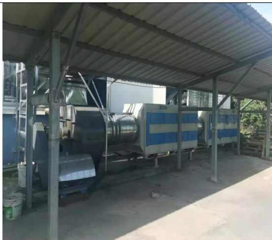
废气处理设施
